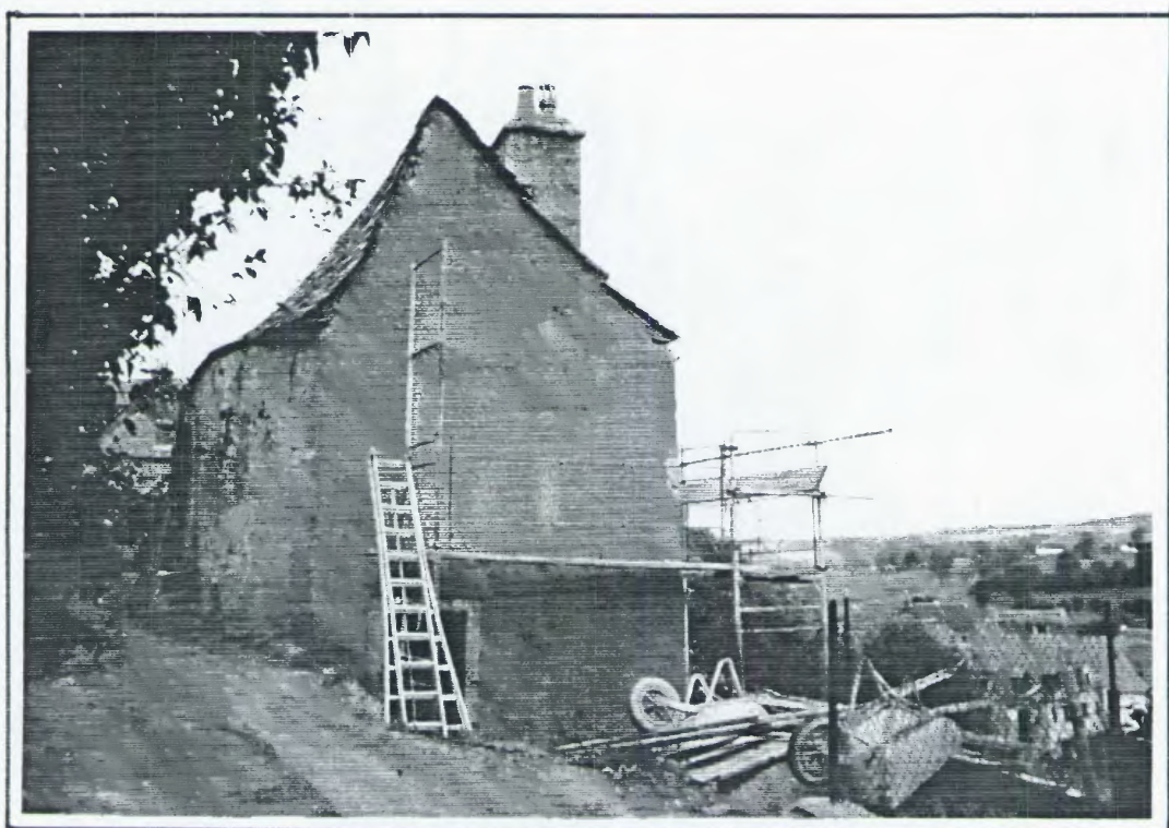
La maison de Mme Walter (ancienne ferme du grand-père paternel), achetée en 1990. Vue sur l'entrée principale. Début des travaux, en août 1994. Aubrac cantalien.
