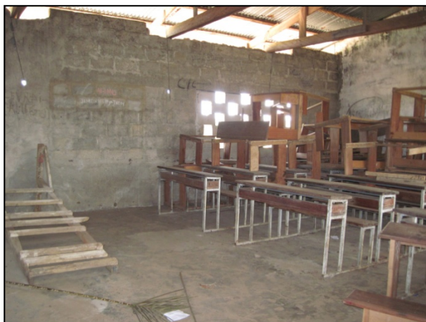
Photo 60. Beaucoup de tables-bancs pourraient être réutilisés après réparation mais demeurent inutilisés dans cette salle
