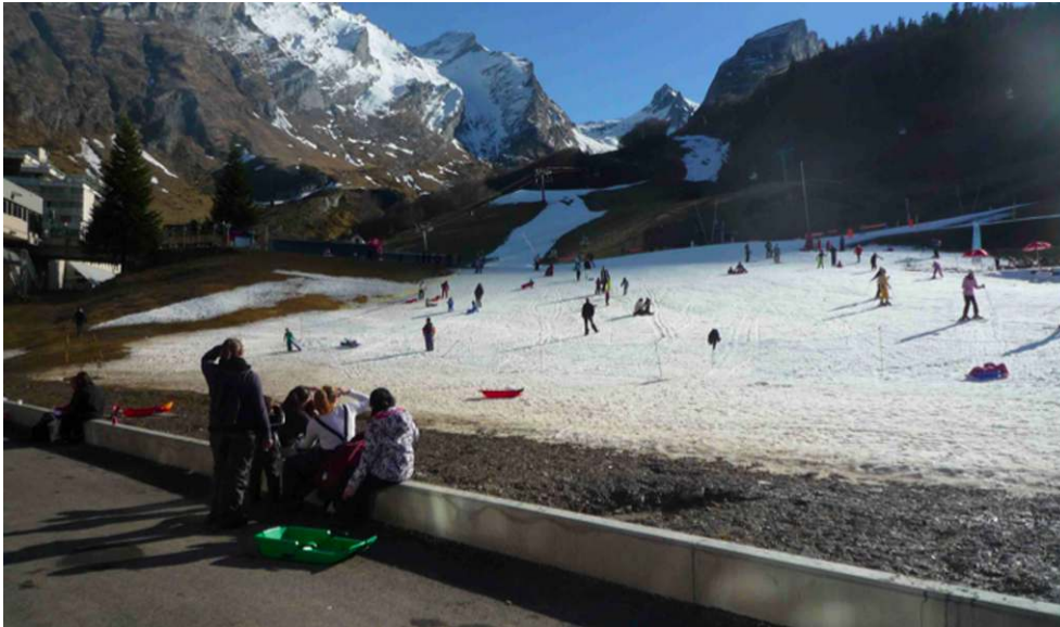
Figure 11. Le front de neige en travaux au niveau de la place Sarrière
