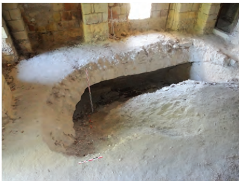
a. Vue de l'effondrement du sol de la salle du premier étage.
