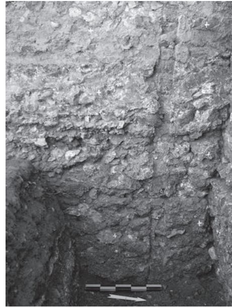
Fig. 13 – Empreinte de madrier sur le parement nord du mur septentrional de l'exèdre A (cliché : B. Bazin, SAVC).
