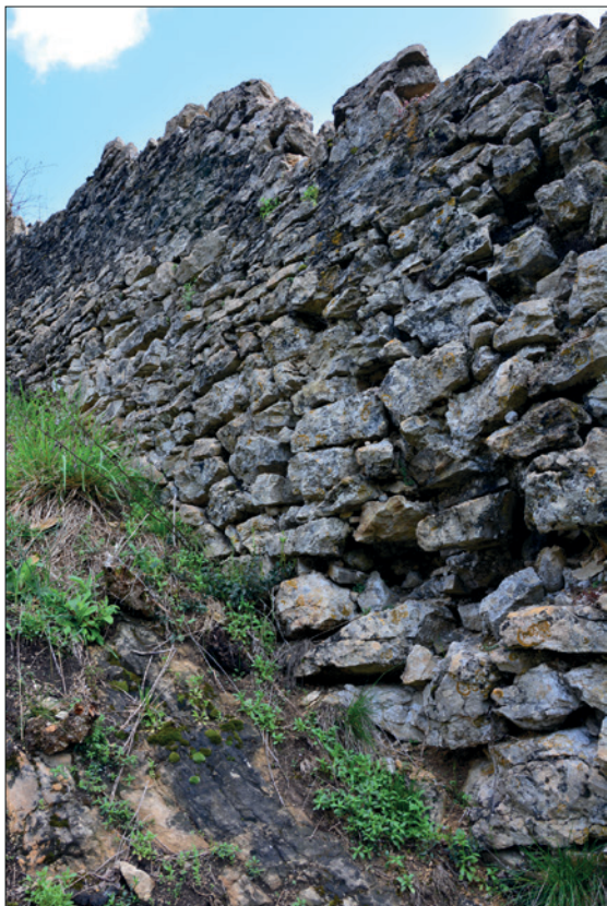
1. Base du parement sapée par l'érosion et des chutes de blocs.
