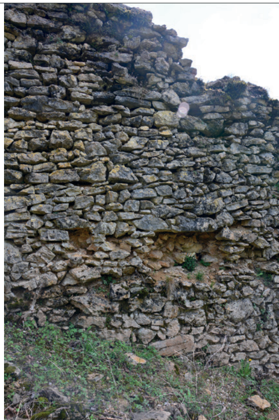
2. Lacunes dans le parement ouest.
