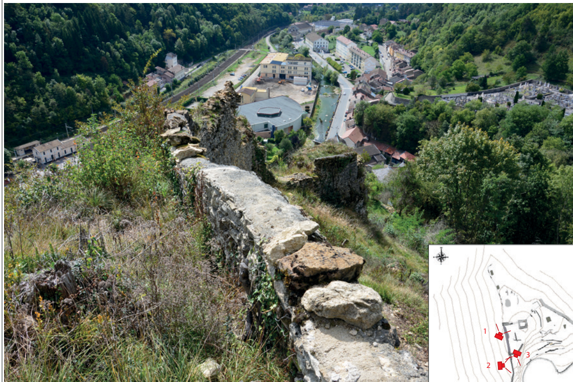
3. Restauration ancienne de la courtine sud-ouest, couvertine dégradée.
