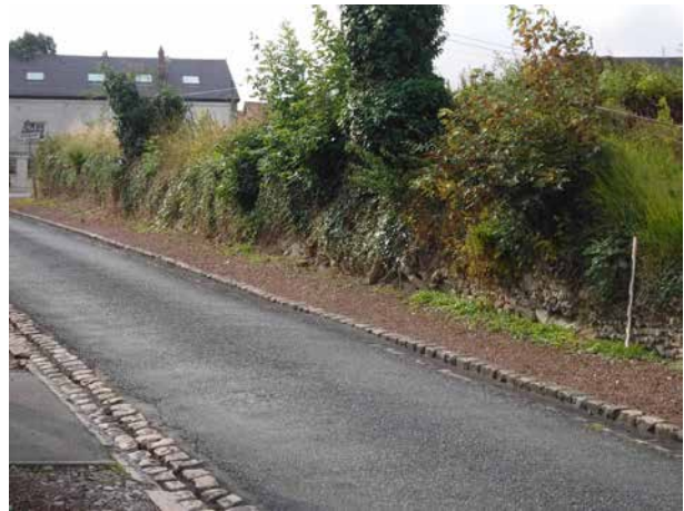
Fig.11 : vue d'ensemble du mur de clôture longeant la rue de la Vaucelette au nord de l'emprise (Us 1082). © Evelyne Gillet - Inrap.
