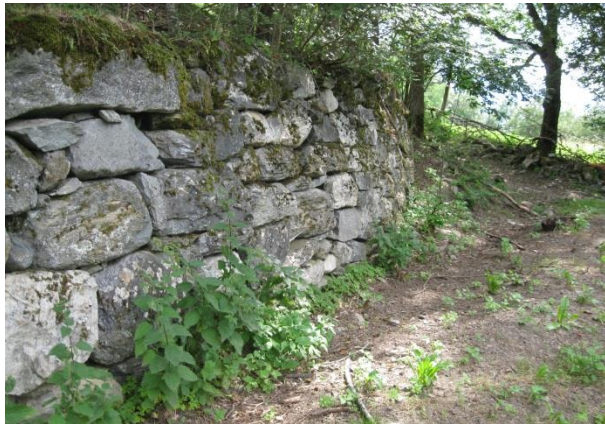
Figure 26 : Canal de Champ-Rond (ou Bied de la Cure), mur de soutènement, Hauteville-Gondon, 5/7/12 (cliché B. Meilleur)
