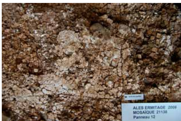
Fig. 9 Limites d'enduits sous les caissons (photo ACRM).
