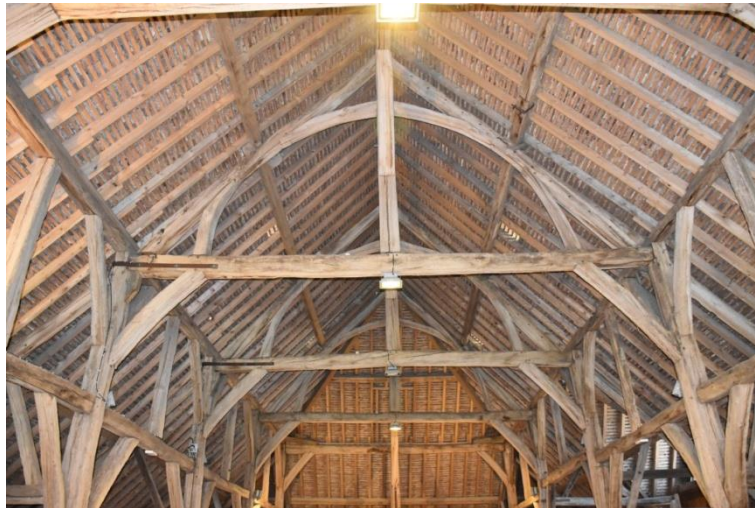
Figure 55 : Vue générale de la charpente de la grange de la Couture (Montoire)
