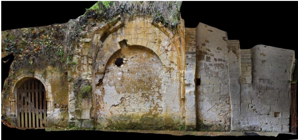
Figure 14 : Élévation ouest de la cave Graffin, parties sud, en avant de la cave à cellules située sous le coteau (à droite)
