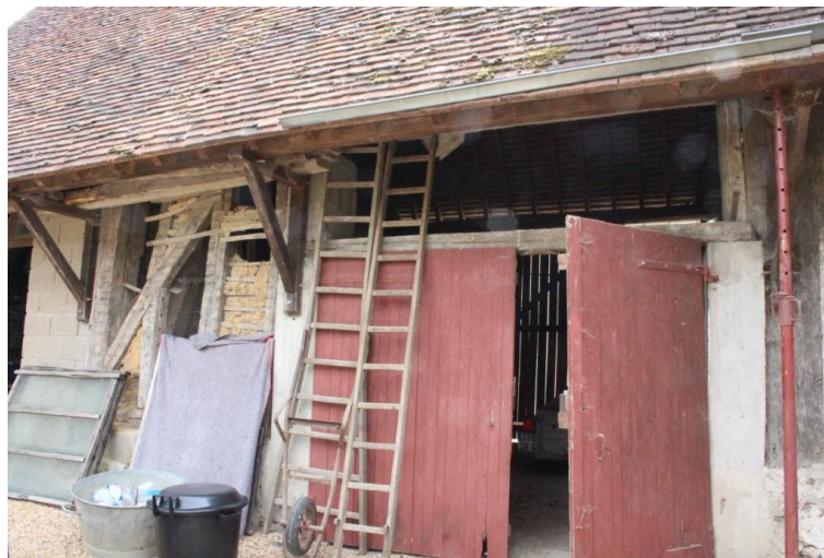
Figure 84 : La grange de la fosse de Ranay (Saint-Martin-des-Bois), pan de bois nord
