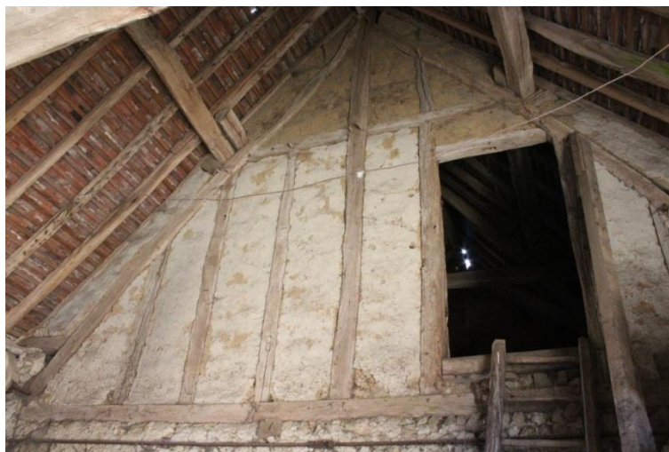
Figure 65 : Ferme intermédiaire de la charpente d'un bâtiment agricole à la Bessonière (Sougé)
