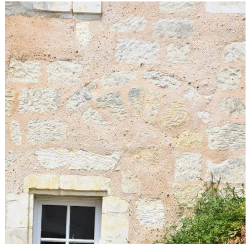
Figure 40 : Détail d'une baie en lancette à double rouleau de claveaux dans le mur sud de la mairie de Sougé
