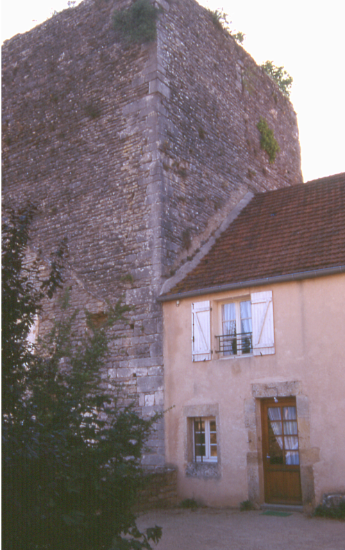
Fig. 8. Vue générale de l'angle nord-ouest. On remarque les blocs d'angle de grandes dimensions, qui contrastent avec le reste de l'appareillage. (Cl. E. Laborier, 1996)
