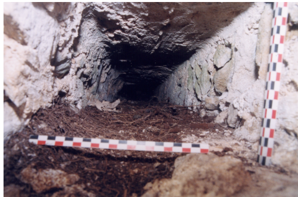
Fig. 11. Vue de l'intérieur d'un négatif de poutre de chaînage intérieur du mur (partie supérieure du mur sud). Il apparaît nettement que les maçonneries (mortier de chaux et pierres) venaient au contact du bois disparu. (cliché E. Laborier, Afan, 1999)
