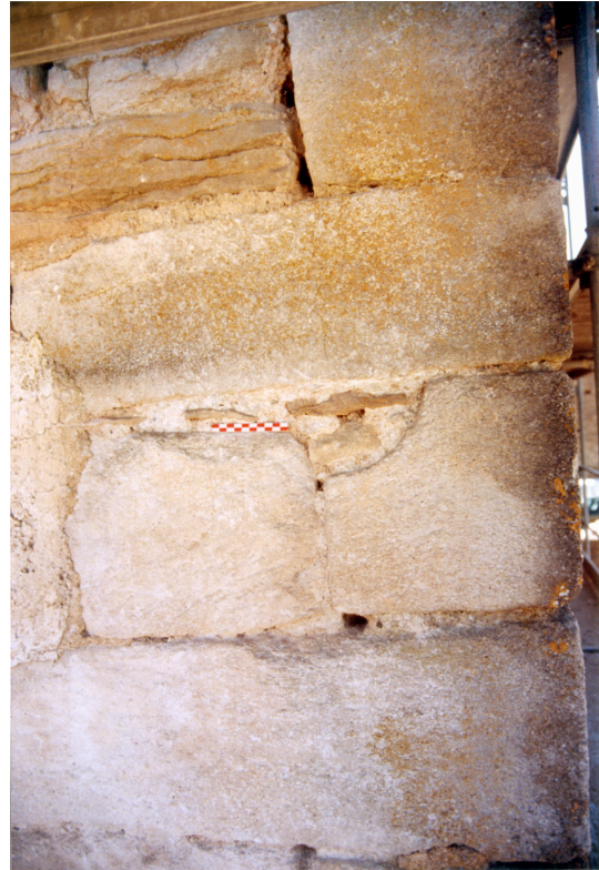
Fig. 9. Vue de détail de l'angle nord du mur est. Dans les blocs d'angle, on trouve des éléments en réemploi, ici un bloc avec un congé. (Cl. E. Laborier, Afan, 1999)
