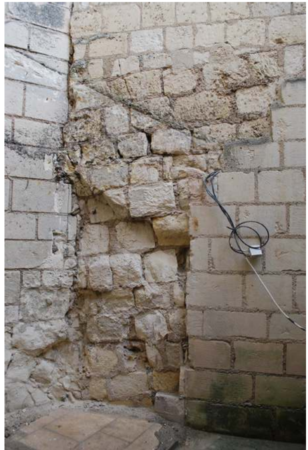
Fig. 11 - Détail d'une portion du mur ouest de la chemise redécouvert en 2015, avec ses assises penchées (P. Papin - Sadil).
