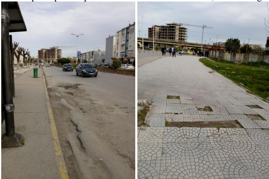
Photos 10 et 11 : Des malfaçons dans la réalisation de la chaussée et ses accessoires (Auteur, 2018)
