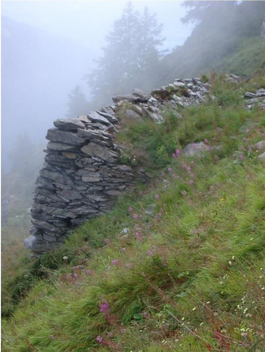
Fig.5 – Mur pare-avalanche (Suisse)
