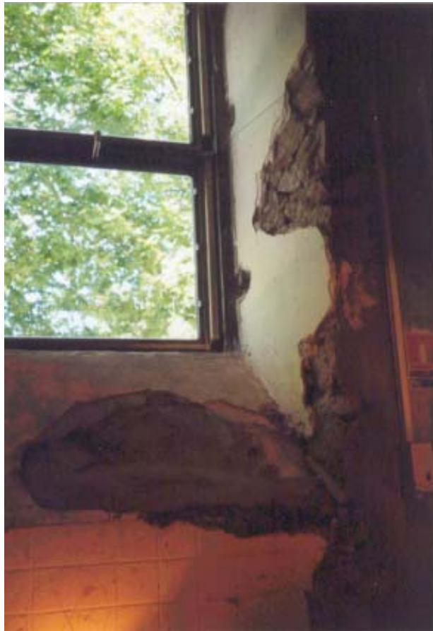
Photo 109 : L'absence de finitions pour cet entourage de fenêtre est à l'image du reste du bâtiment, lieu unique à Nantes
