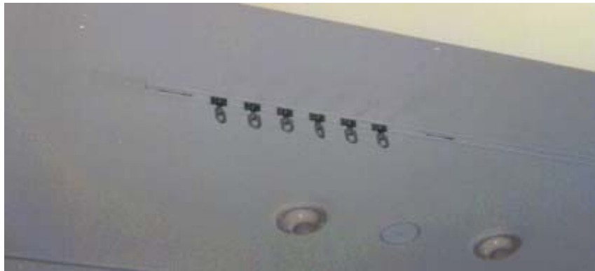
Photo 25 : Le plafond du FRAC des Pays de la Loire à Carquefou est équipé de système permettant d'accrocher des cloisons mobiles.
