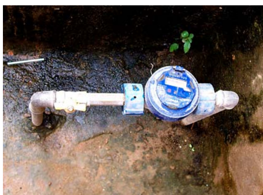
Figure 8: Installation d'un compteur individuel dans le favela Prado Lopes (Photo MS2005)
