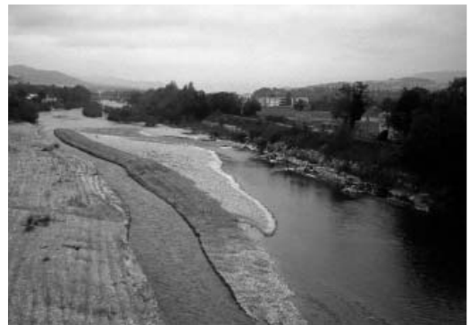
Photographie 4 – Essartage, dessouchage, scarification et tranchée de re-mobilisation dans une zone endiguée (cliché N. Landon, 2003)
