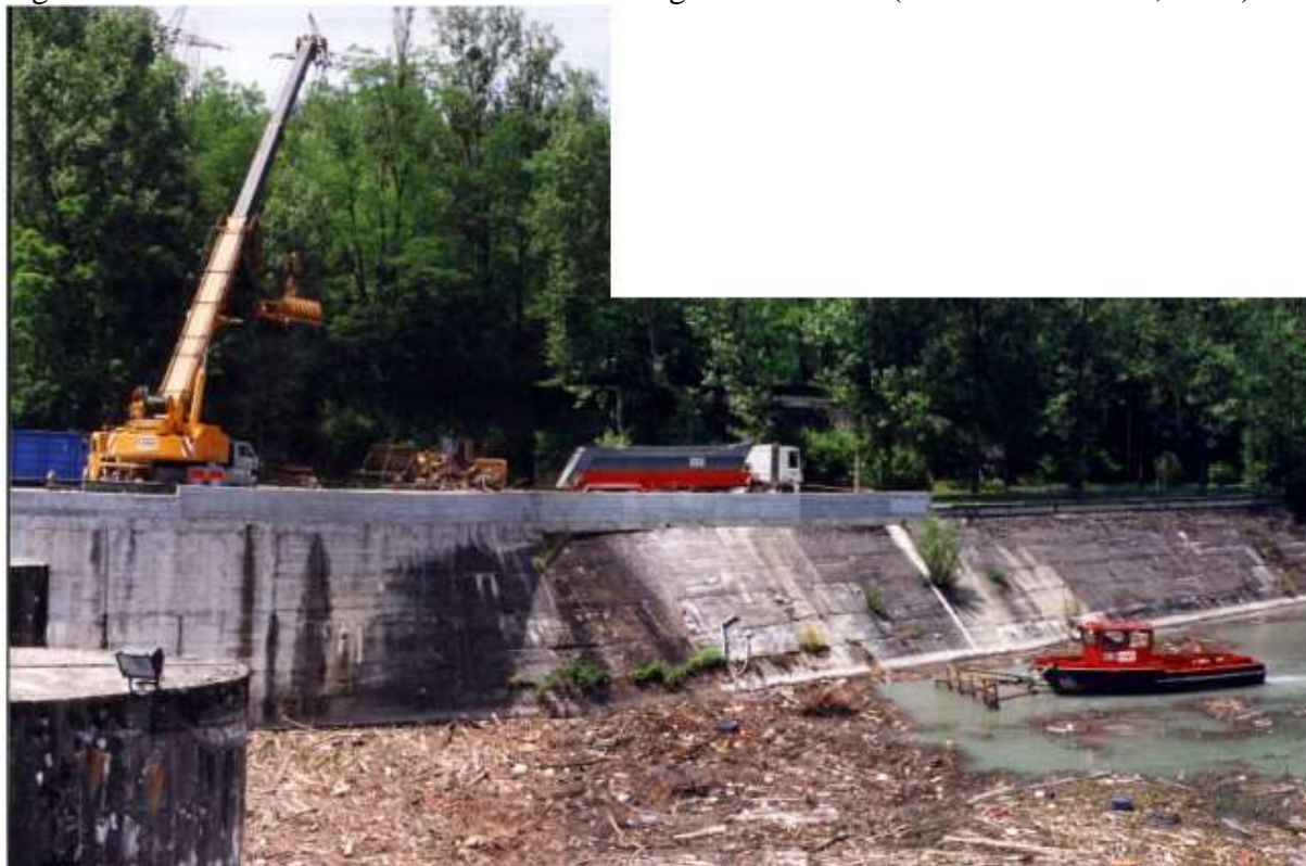
Figure 2. L'extraction des bois flottants au barrage de Génissiat (cliché : Moulin B., 1999).
