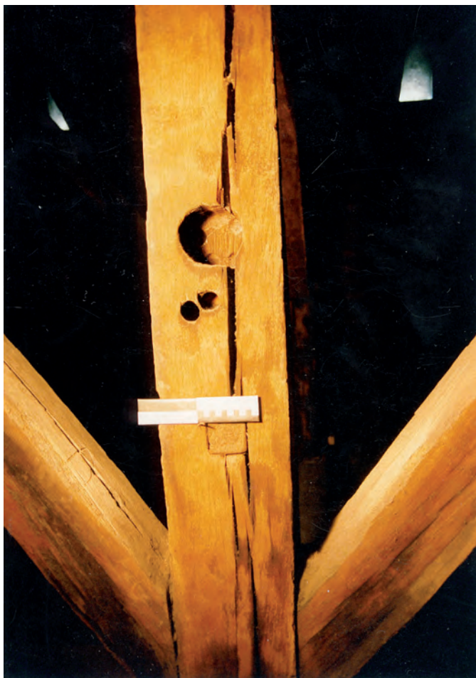
Fig. 83 : Entailles de fixation d'un cabestan sur le poinçon d'une ferme principale. Cathédrale de Rouen (1227-1232d).
