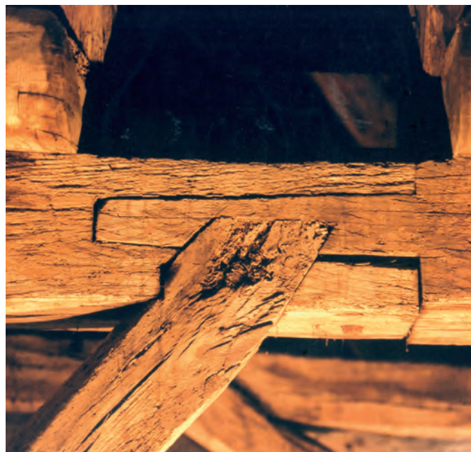
Fig. 37 : Enfoulement des sablières hautes superposé au mi-bois d'un lien de contreventement.
