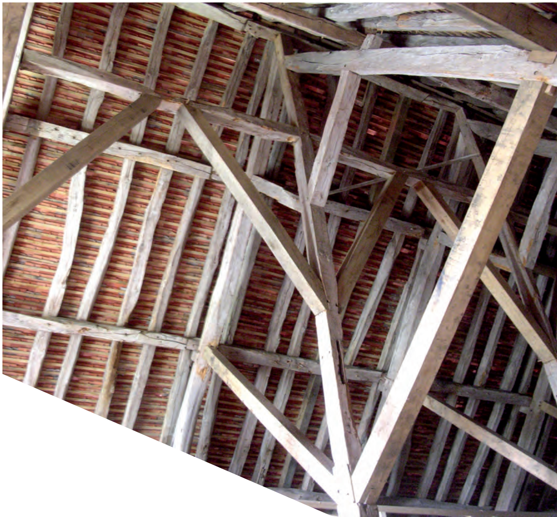
Fig. 21 : Dispositif longitudinal avec ses sous-faîtières soulagées par des liens de contreventement restitués en 2005.
