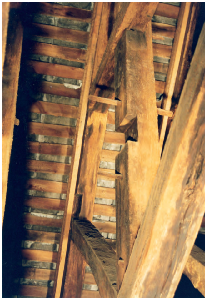
Fig. 84 : Échelons d'une échelle de perroquet sur un poinçon. Cathédrale de Rouen (1227-1232d).
