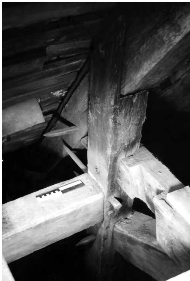
Fig. 22 : Décalage du poteau aux assemblages du chevron, de l'écharpe et de l'entrait retroussé.
