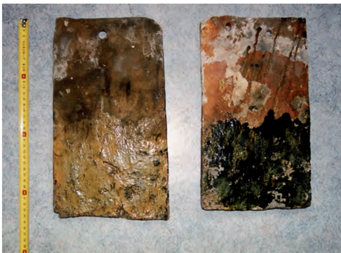
Fig. 115 (1 et 2) : Tuiles glaçurées retrouvées en réemploi dans les toitures de la cathédrale de Lisieux (fin XII e siècle?).
