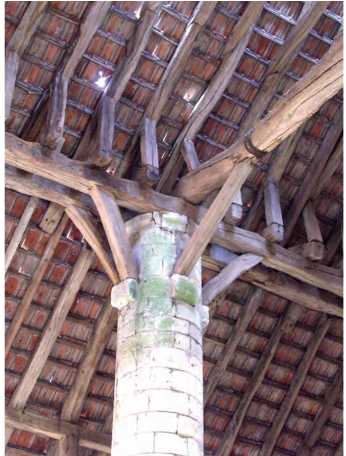
Fig. 159 : Réception d'une ferme principale sur une pile, 1189/1190d. Grange de Warnavillers (Oise).
