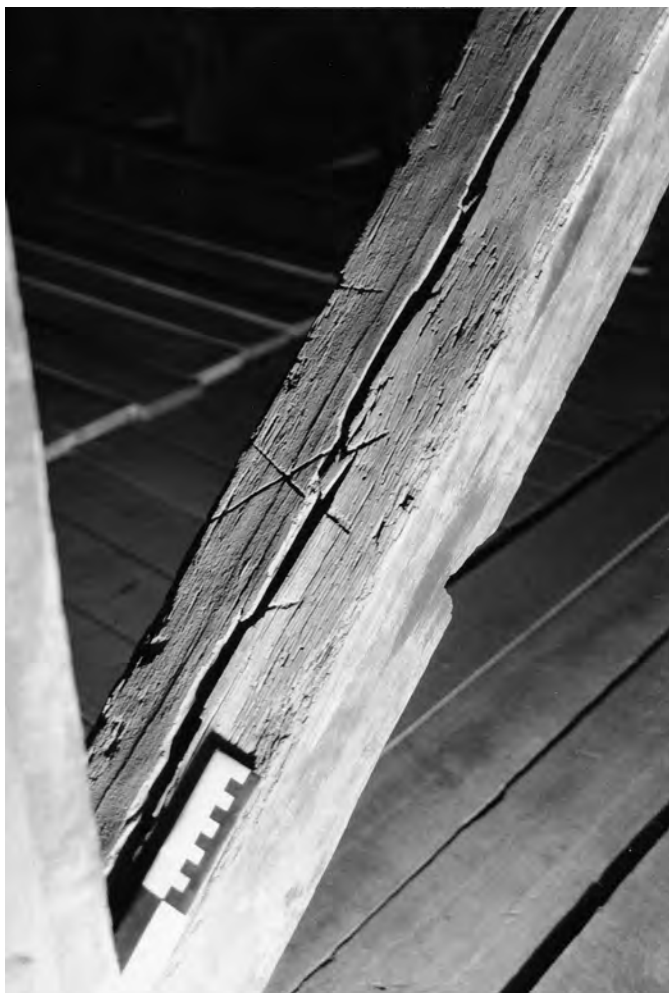
Fig. 28 : Marque d'assemblage déformée par une fente de séchage. Cathédrale de Rouen, 1227-1232d.
