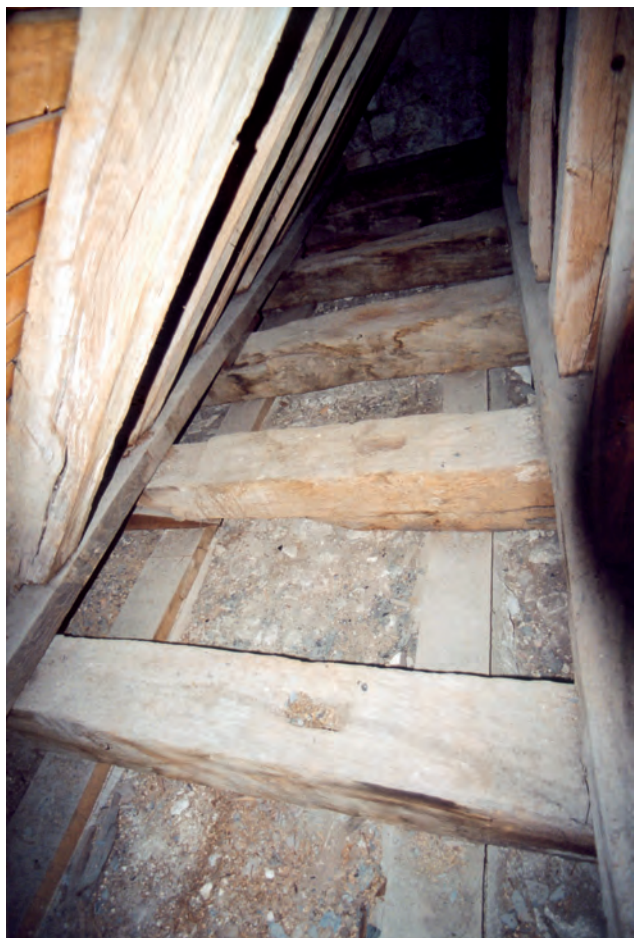
Fig. 12 : Croisillon sud : extrémité des entrails avec leurs mortaises vides.
