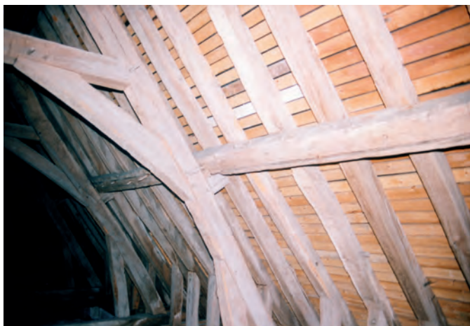
Fig. 18 : Charpente de la nef, réemploi d'un entrain roman en panne.
