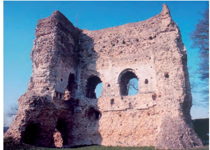
Fig. 127 : Donjon de Brionne (Eure). En partie haute, on voit les encastresments des entrails des fermes rapprochées, protégées par le réhaussement du mur.
