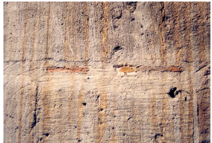
Fig. 34 : Tuiles vernissées servant de cales dans les maçonneries du XIII e siècle de la tour-lanterne.
