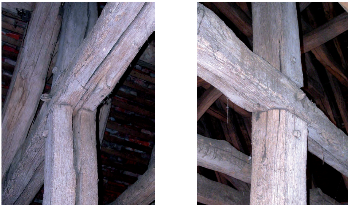
Fig. 106, 1 et 2 : Chevilles servant à bloquer l'ouverture des fentes du bois. Grange Saint-Lazare de Beauvais (1220d).
