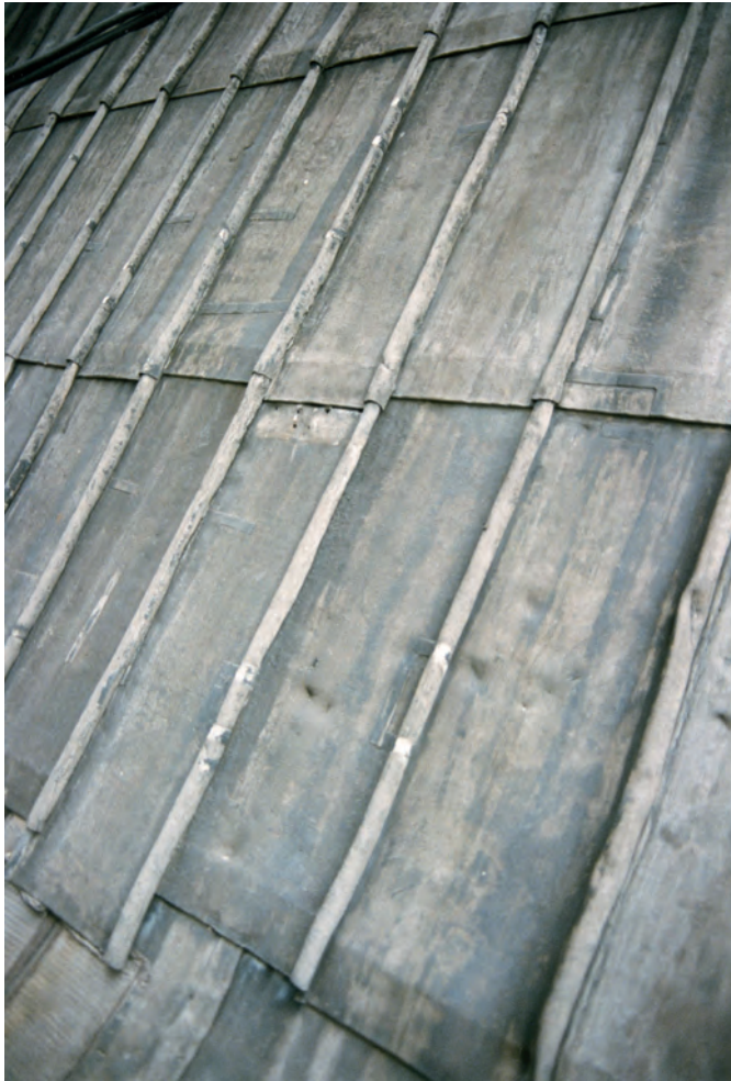
Fig. 122 : Tables de plomb (médiévales?) des travées occidentales de la nef de la cathédrale de Rouen.
