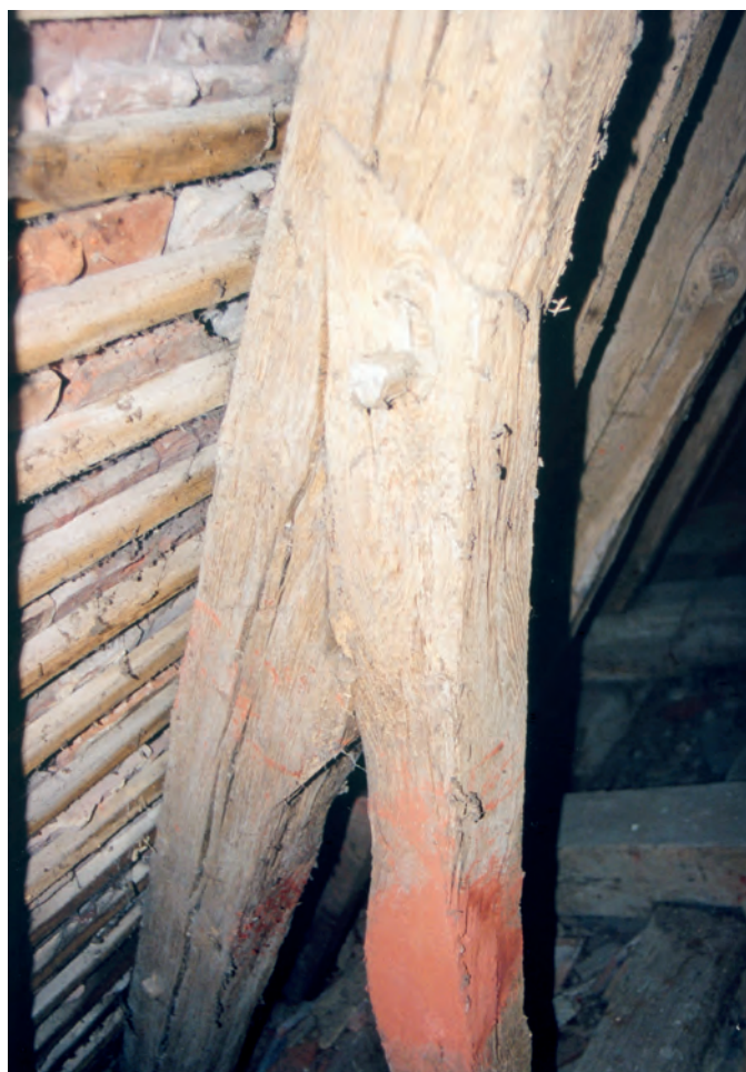
Fig. 8 : Retrait du chevron sous l'assemblage à mi-bois avec ergot de la jambe de force.
