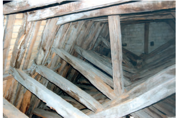
Fig. 79 : Écharpes des fermes du croisillon nord, décalage des assemblages du fait de la torsion des bois.
