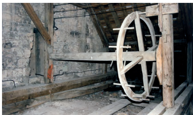
Fig. 94 : Cabestan d'époque moderne fixé entre deux fermes principales. Abbatiale de Fécamp, comble du chœur.
