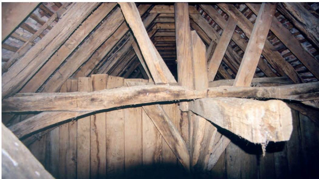
Fig. 7 : Courbure et délardement du faux-entrait d'une ferme principale.
