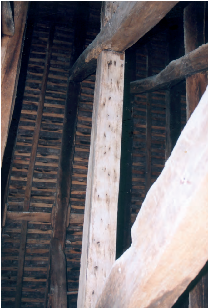
Fig. 32 : Négatif du lattis de couverture sur un chevron réemployé.
