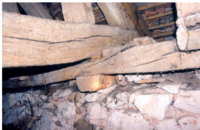
Fig. 9 : Cale placée sous l'enture des sablières, au droit de la ferme principale médiane.
