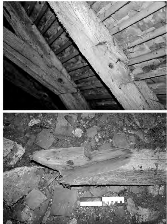
Fig. 135 : Assemblage à mi-bois avec ergot, début XIII e siècle. Église de Quatremare (Eure).
