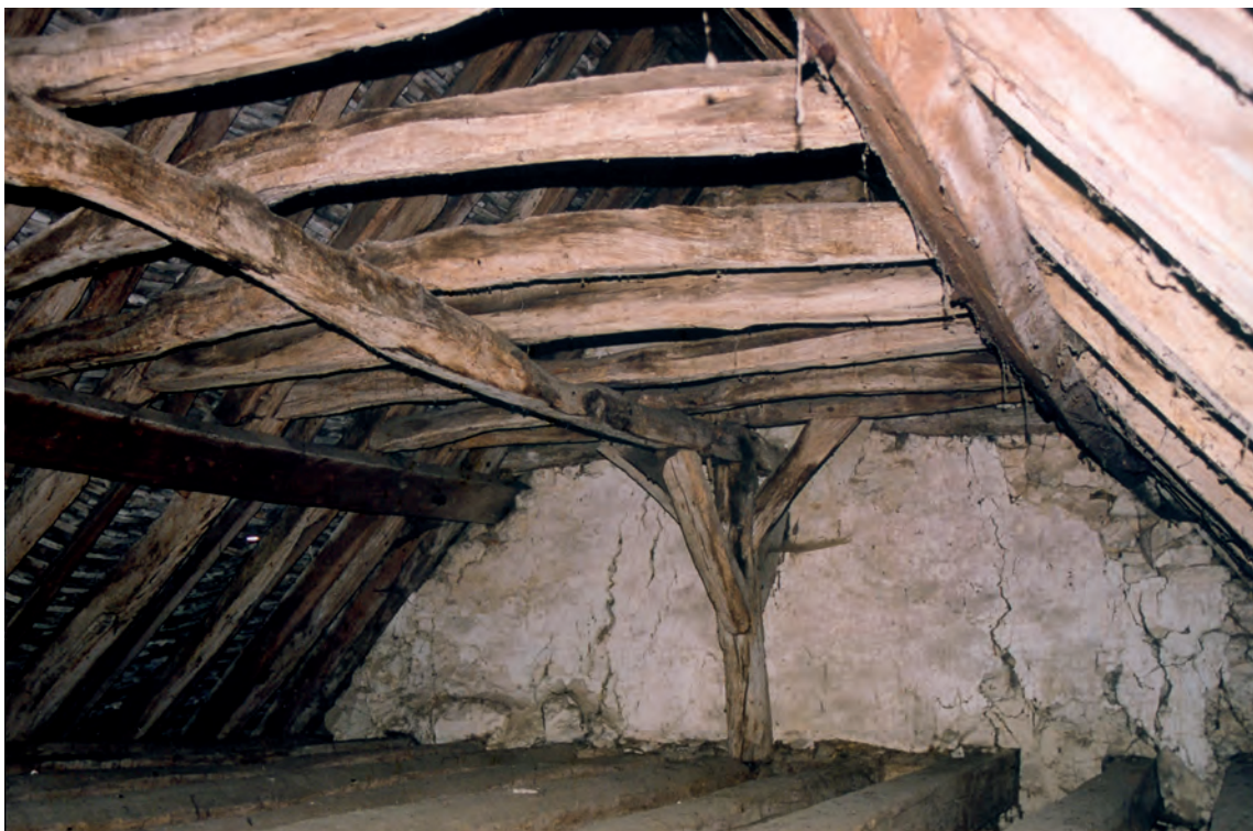
Fig. 5 : Charpente de la nef (1224d), amputée au fond par le mur-pignon du XVIII e siècle.
