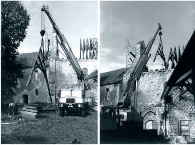
Fig. 88 : Levage à la grue des fermes du XIII e siècle de la chapelle de Chamu, Eure (photo : Charrier).
