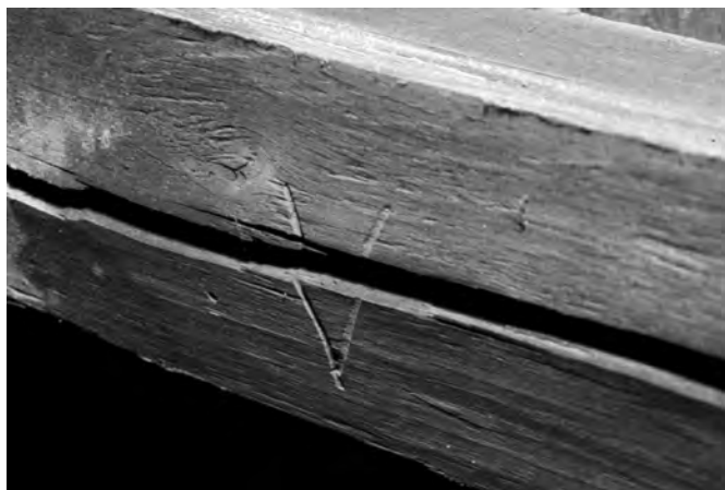
Fig. 33 : Marque déformée par une fente de séchage.
