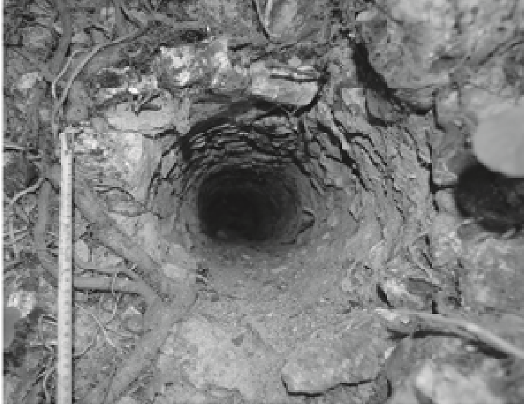
Fig.1 Logement d'une longrine ce section circulaire, dans le sens longitudinal du mur d'enceinte, shell-keep de Vatteville-la-Rue (76)
