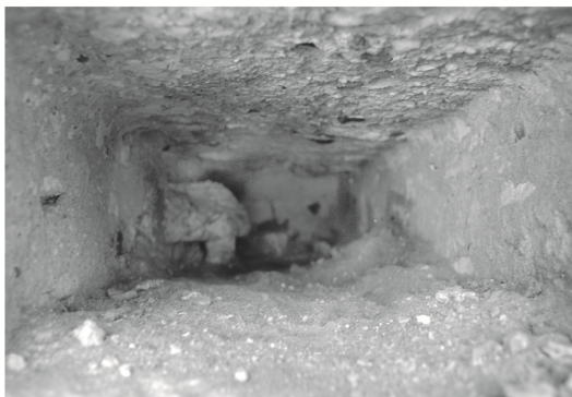
Logement d'une traverse avec l'empreinte au mortier d'une mortaise et d'un trou de cheville présents dans le bois
