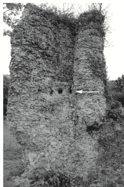
Tour Saint-Nicolas, vue sud, avec l'emplacement des poutres à mi-hauteur des murs
