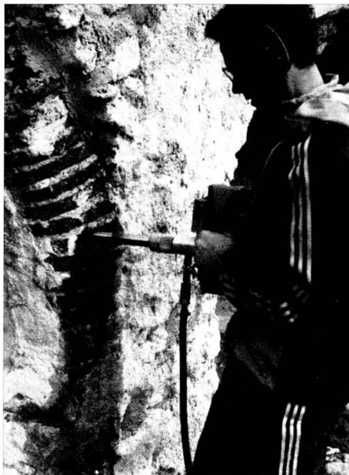
Figura 9. Cuando tejas y ladrillos siguen empotrados en un monumento, es posible efectuar directamente unas extracciones mediante una herramienta (para sacar muestras) portátil (este método necesita una restauración de la construcción): ejemplo de extracción de un testigo del acueducto de Ansignan (cerca de Perpignan, Pirénées Orientales, Francia). El diámetro de la muestra es de 25 mm. Es necesario, en este caso, extraer 100 a 150 muestras por lote
