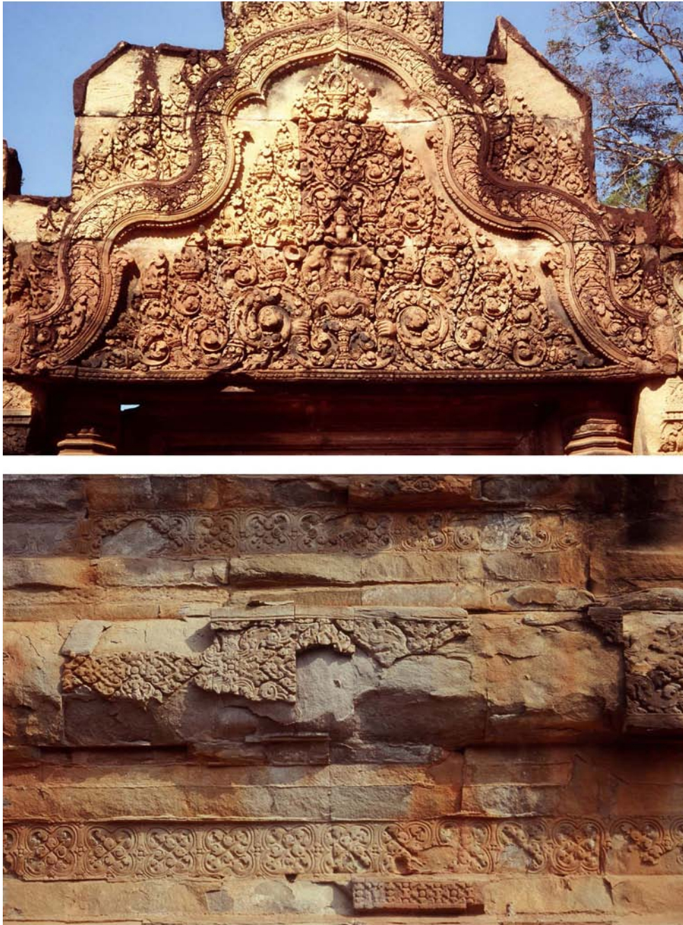
Figure 4. L'influence de la perméabilité des grès sur la conservation des éléments sculptés (temples d'Angkor, Cambodge). En haut, excellente conservation des motifs sculptés dans les grès roses peu perméables de Banteay Srei (fin du X ème siècle). En bas, état avancé de dégradation des bandeaux sculptés dans les grès gris très poreux de Ta Keo (début du XI ème siècle). © M.-F.André.
