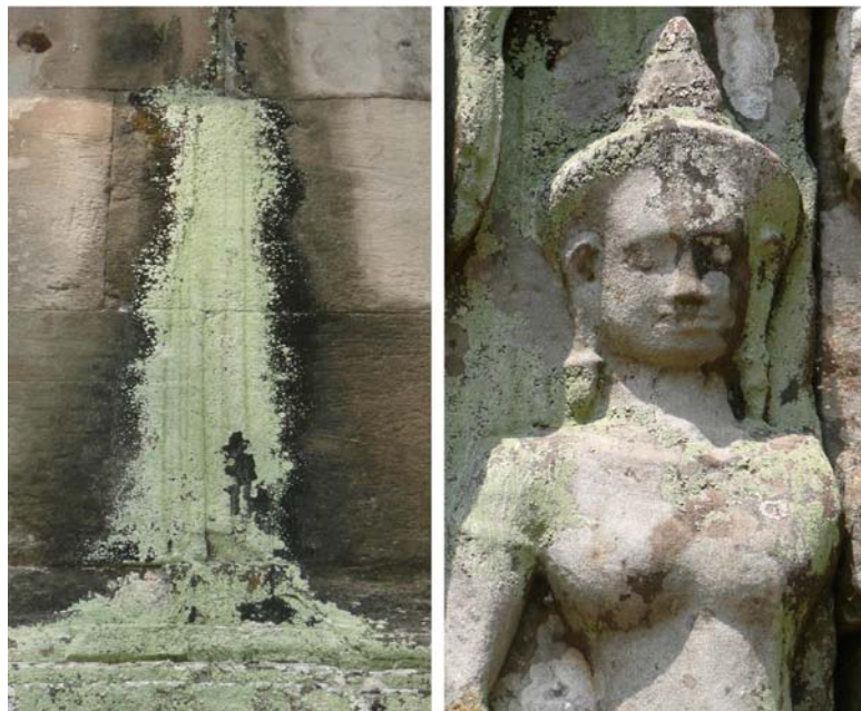
Figure 5. Cheminements de l'eau et colonisation végétale des monuments : le cas des temples d'Angkor. À gauche, une zone de suintements est soulignée par une traînée de lichens verdâtres encadrée d'auréoles noires d'origine cyanobactérienne (temple de Ta Keo). À droite, on retrouve ces lichens pulvérulents associés à des lichens crustacés blancs sur la statue d'une divinité (temple de Banteay Kdei). © M.-F. André.
