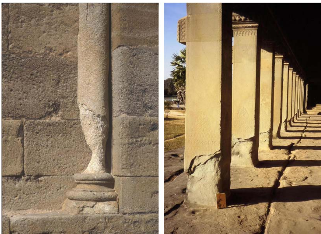
Figure 2. Les effets combinés des remontées capillaires et des propriétés des matériaux de construction. A gauche, base d'une colonnette rongée par la décomposition chimique d'un grès poreux (église de Mailhat, Puy-de-Dôme). À droite, base de piliers en grès micacés rongée par l'altération (Angkor Vat, Cambodge) ; les remontées capillaires sont ici guidées par l'orientation des micas qui se trouvent à la verticale suite à la pose en délit des pierres. © M.-F. André.
