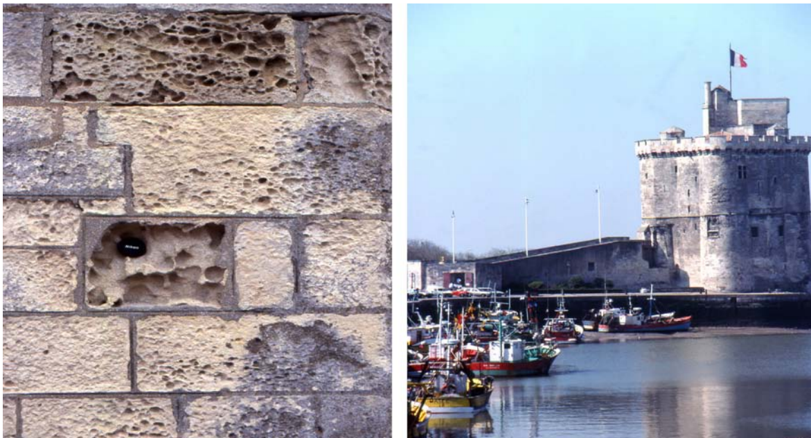
Figure 3. Alvéolisation des calcaires exposés aux eaux salées des embruns littoraux (Tour Saint-Nicolas, La Rochelle). © M.-F. André.
