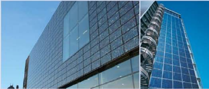
Bardage solaire en modules au silicium multicristallin (façade bleue)
