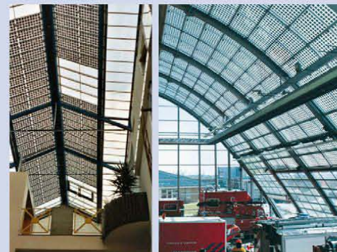
Verrières photovoltaïques à modules semi-transparents au silicium cristallin
