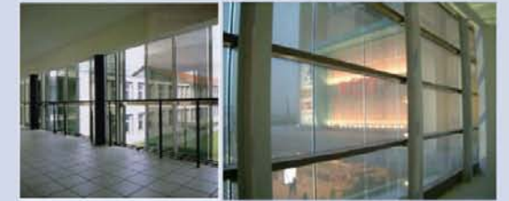
Murs-rideaux en modules au silicium en couche-mince
