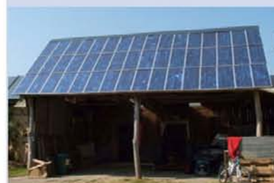
Hangar photovoltaïque à modules au silicium multicristallin
