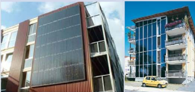
Bardage solaire en modules au silicium en couche-mince (façade noire et bleue)
