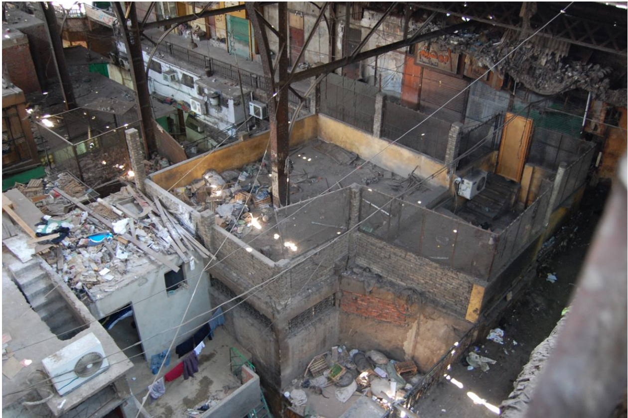
Photo 4 et extrait du plan du rez-de-chaussée : emprise du restaurant LUX à l'intérieur du marché (photo P. Garret - 2008 et plan P. Garret - 1995)
