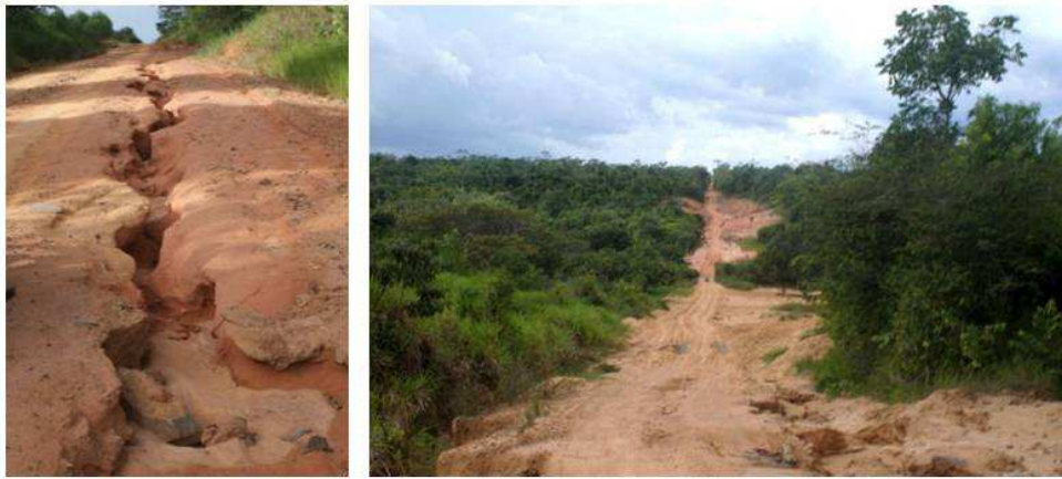
1. Le fossé peu après Braço qui avait provoqué ma chute ; 2. La route très sableuse proche de la communauté « Portão de ferro », qui représente le début de la zone dénommée Estrada Nova.
