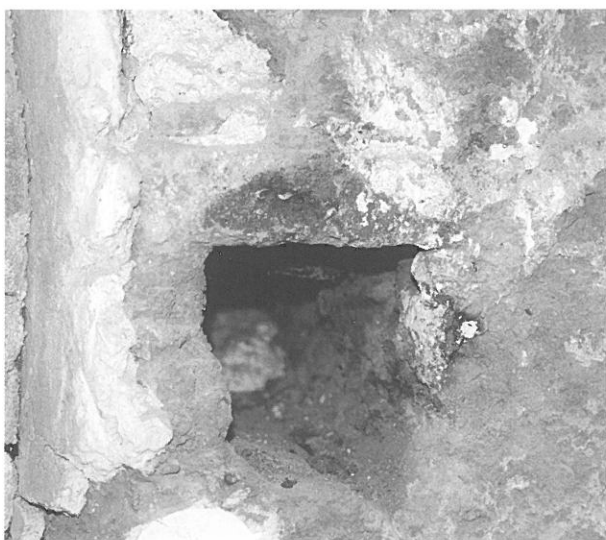
Fig. 16 : Négatif d'une grande clé de fixation de banche dans un mur de pisé. Son couverture est fait d'une lauze.
