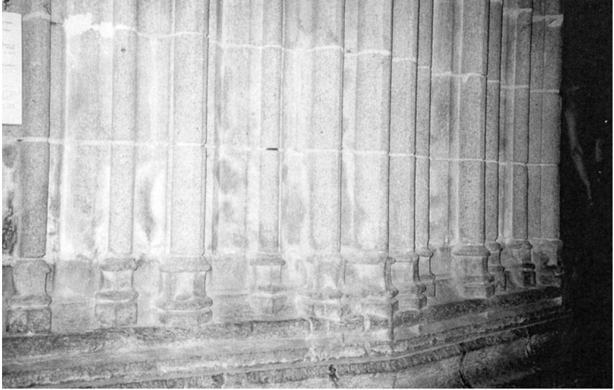
Figure 7 : Quimper, cathédrale Saint-Corentin, pilier du revers de façade à gauche de la porte d'entrée (cl. J.-M. Guillouët)
