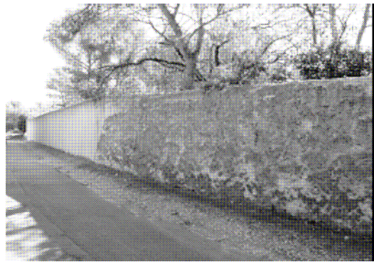
8. Jonction de l'ancien mur et du mur construit au milieu des années 1980.
