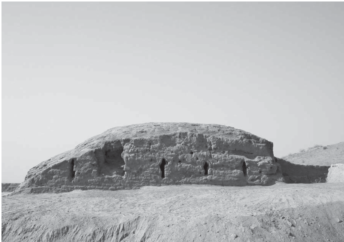
Fig. 29 Tchingiz Tepe 1: Façade occidentale de la tour 5 avec cinq archères. Vue vers l'ouest.
