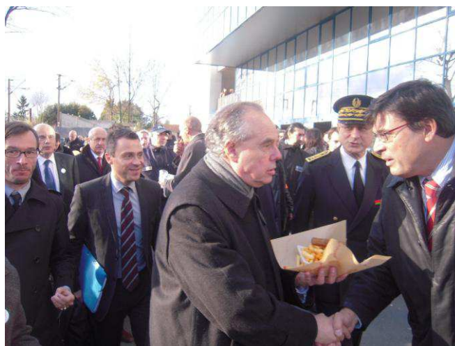
Pose de la première pierre du Louvre Lens par le ministre de la Culture et de la Communication au stade Bollaert, Lens, le 4 décembre 2009 (Photographie, Jacques Lemièr)
