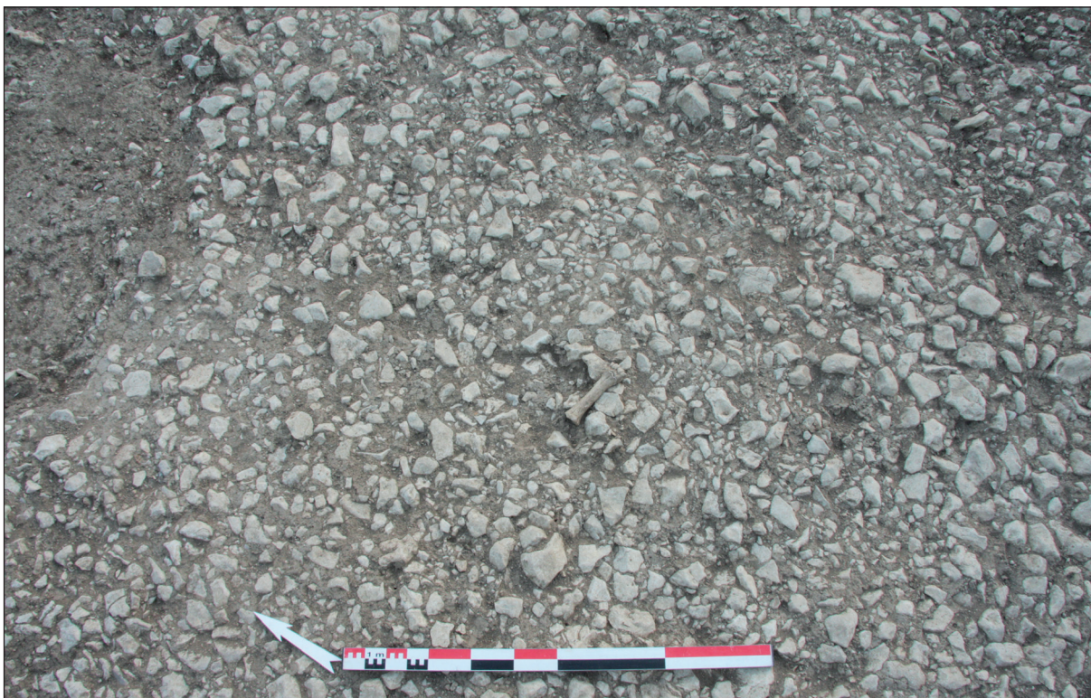
Fig. 11 - Voie VO 7096 : détail de la bande de roulement déteriorée
