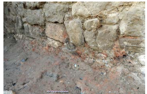
■ Fig. 36 : Vue de détail de l'enduit rubéfié 77340 présent contre le parement du mur MR77070; depuis le nord-est.
