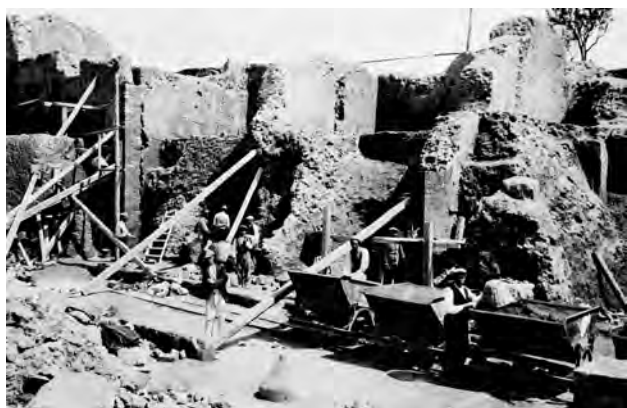
Fig. 110 – Façade de l' Insula Orientalis II a en cours de fouille. Les éléments de maçonnerie fragilisés par les tunnels du XVIII e siècle sont soutenus par des étais le temps de leur reconstruction.
