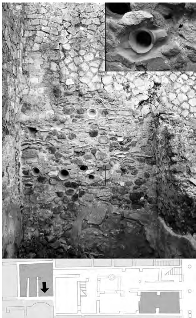
Fig. 149 – Casa a graticcio (III, 13-15), pièce 12, mur sud. Fortement endommagée lors du séisme de 62, cette paroi, qui appartient alors à la Casa dello scheletro (III, 3) a été reconstruite en utilisant des moellons de récupération, mais également des amphores (encadré).
