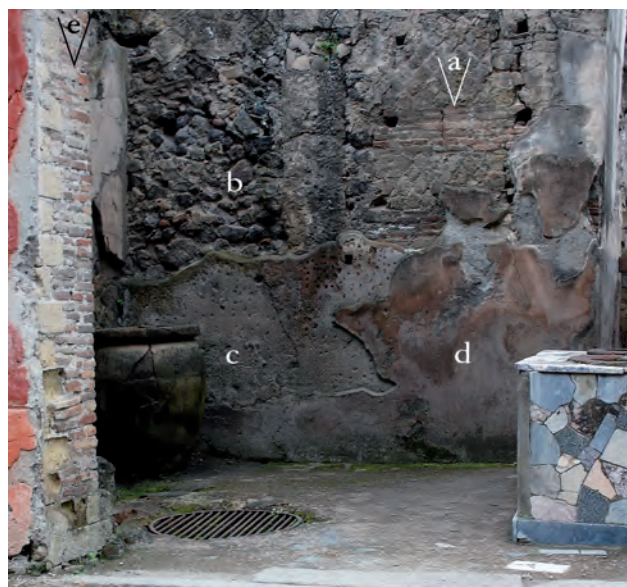
Fig. 176 – Casa dell'Apollo citaredo (V, 9-12), boutique V, 9-10, mur sud. La paroi porte les stigmates du premier séisme : l'entrechoquement du mur sud et du mur est les a fait s'écrouler ; ils ont été réparés en opus reticulatum A alterné avec des assises de tuiles (a), les montants d'entrée avec des tuiles (e). Après ces réfections, la porte donnant au sud sur l'atrium a été bouchée (b) et la paroi enduite à deux reprises (c, d), correspondant aux phases du commerce alimentaire V, 9-10.
