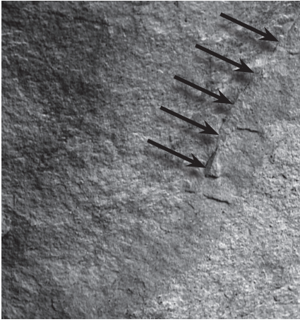
Fig. 6. Fissure visible dans la paroi de l'abri d'Iheren.
