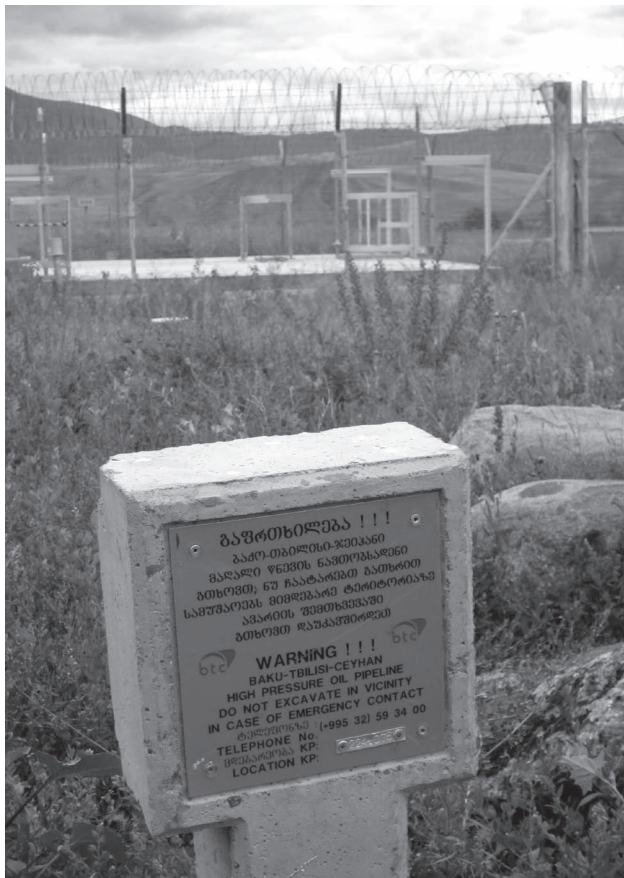
10. Une station de contrôle de l'oléoduc BTC près d'Akhalsikhe au sud-ouest de la Géorgie
