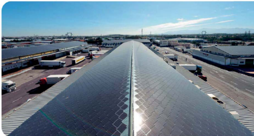
Photo 4. Centrale solaire photovoltaïque du marché international Saint-Charles de Perpignan (Source ADEME)
