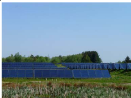
Photo 2. Centrale solaire thermique connectée au réseau de chaleur de Braedstrup (Danemark)
