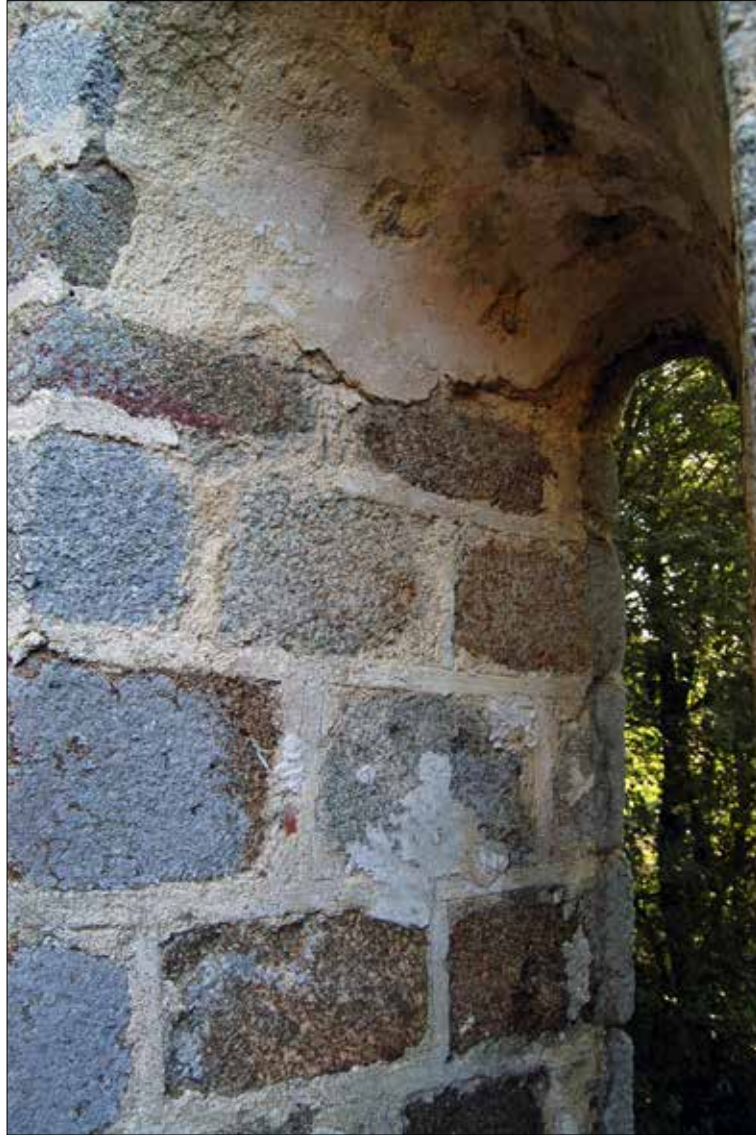
Fig. 4 - Saint-André-des-Eaux (Côtes-d'Armor), ancienne église Saint-André, chœur, détail de l'appareillage du piédroit nord de la baie axiale. Cl. Mathias Dupuis
