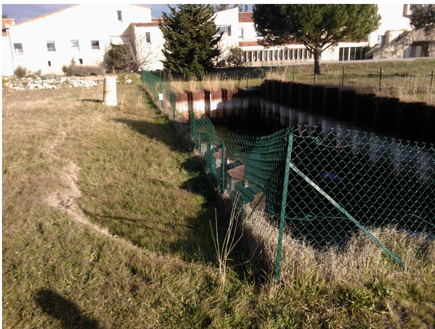
■ Fig. 5 : Vue depuis l'ouest de l'affaissement de terrain survenu hiver 2013, consécutif au fléchissement des palplanches de la zone 1
