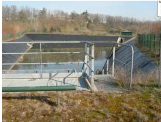
figure 14 : le premier bassin de rétention de Minerve (hiver 2011)
