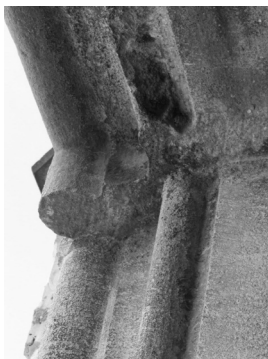
▲ Fig. 187 : défaut d'adaptation de la traverse de la demi-croisée de la chambre du 5 e étage.
