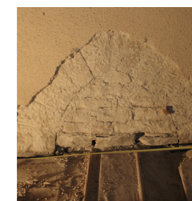
▲ Fig. 152 : couverture en arc tiers-point des empochements des poutres de la salle.
