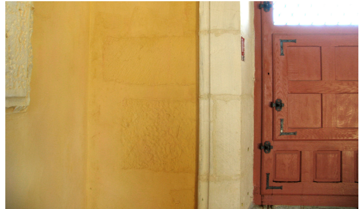
▼ Fig. 61 : cannelures pour pose de tasseaux de lambris taillées dans une queue de chaîne d'angle (tour de la Terrasse, 7 e étage, croisée nord-ouest, montant ouest).
