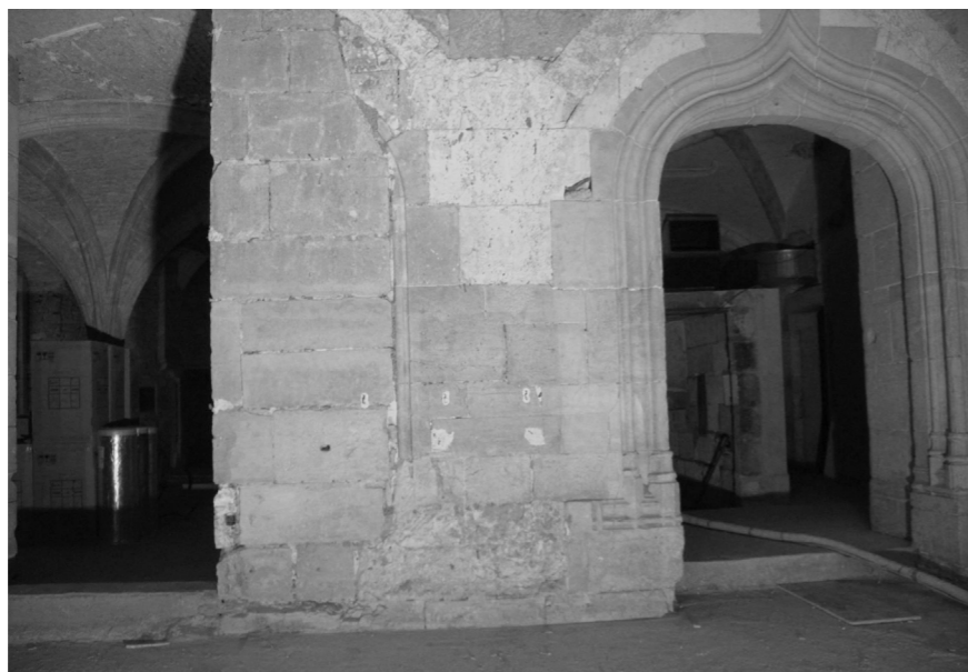
► Fig. 86 : façade est, portes du rez-de-chaussée. État avant restauration, mars 2012.
