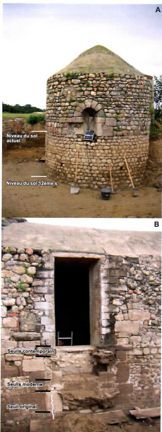
Fig. 3 – Exemple d'impacts directs sur le bâti : la chapelle Sainte-Eugénie-de-Tresmals
