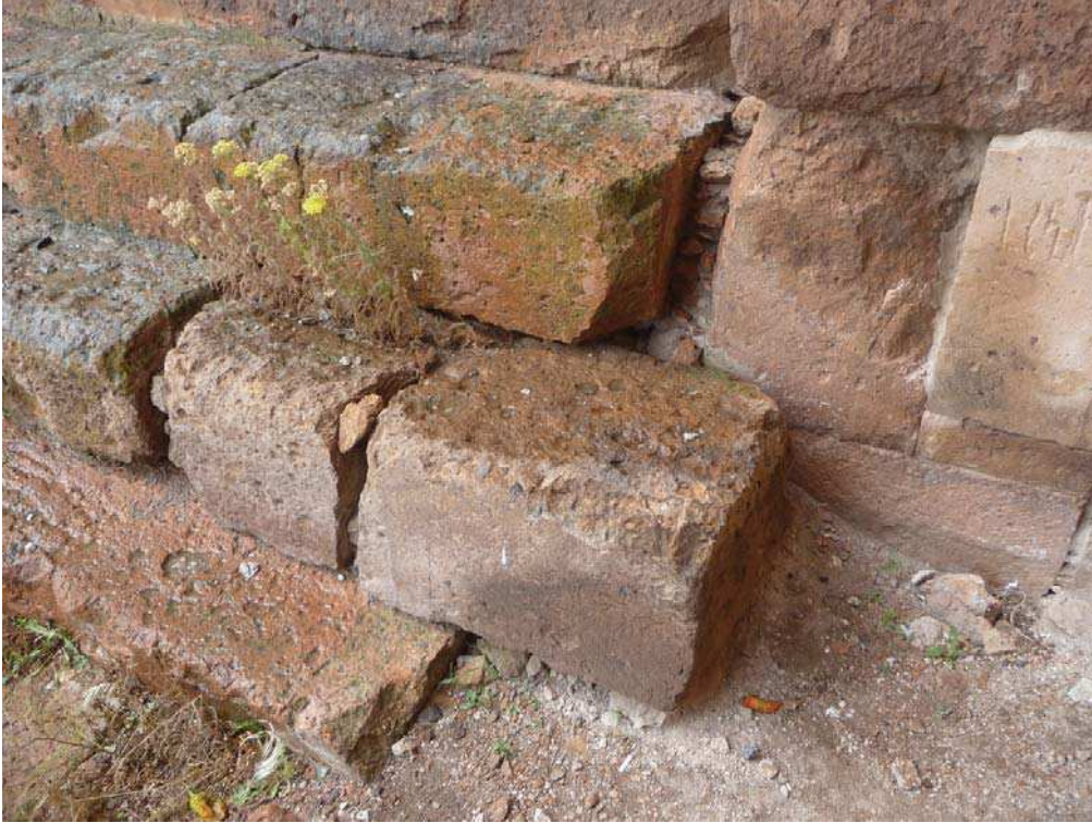
Fig. 25 – Ereruyk. Basilique, façade sud, extrémité est du mur gouttereau. Jonction des gradins du bas du mur et de l'absidiole sud-est. Cliché : A. Hartmann-Virnich (LA3M, 2014).
