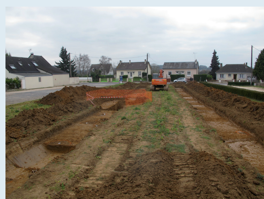
L'exiguïté de l'emprise est assez caractéristique de ce type d'intervention en centre bourg, plus ou moins densément bâti. © Inrap
