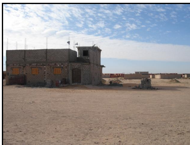
Photo n°4. Coopérative immobilière à Adrar (Cheik-Mohamed-Ben-Lekbir) : retard flagrant dans la construction (excepté une salle de prière destinée pour la cité des logements sociaux et LSP)
