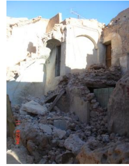
Photo n°3 : Etat de dégradation des maisons du ksar d'Ouargla.
