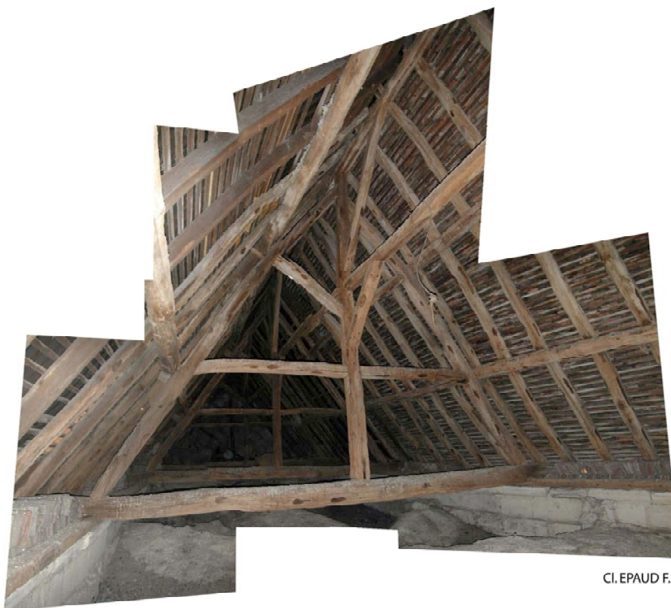
Fig. 45 : Église Saint-Aquilin de Fontenay-en-Parisis. Charpente du chœur, milieu du XIII e s.
