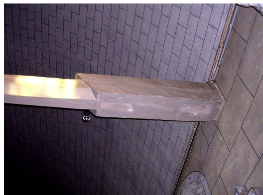
Mortaises bouchées en sous-face de l'entrait
