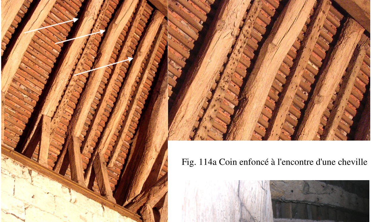
Fig. 113 Vues des entailles aux arêtes des chevrons pour l'accroche des cordes de levage
