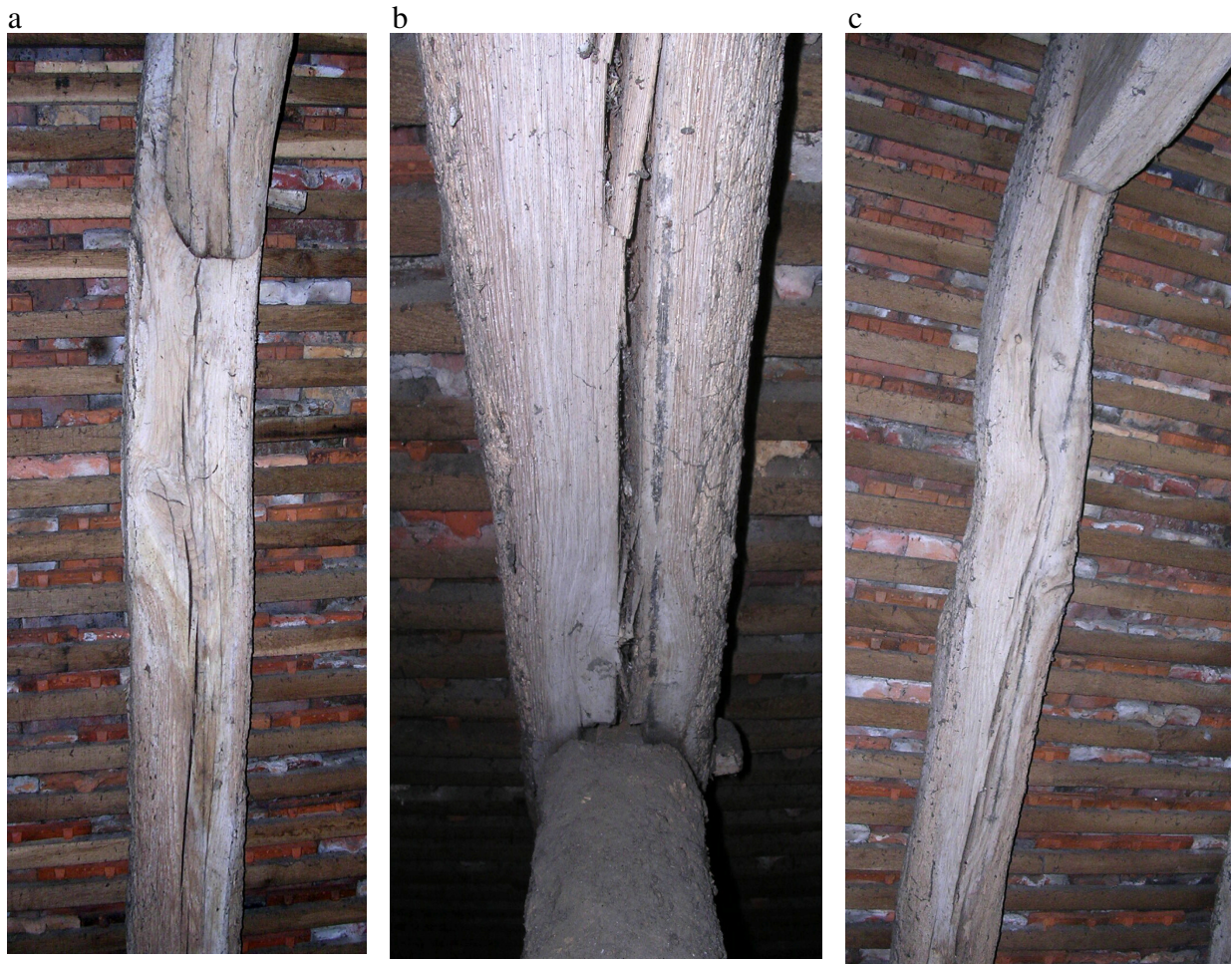
Fig. 101 Tracés de lignage au noir de charbon : (a) double tracé suivant les flancs de la mortaise, (b) trait unique sur un seul flanc de la mortaise et (c) tracé unique "sortant" du bois tors.
