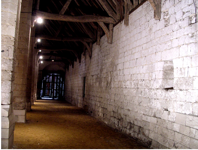
Fig. 20 Mur gouttereau sud : niche du XIIIe siècle au premier plan et baie moderne au second plan.
