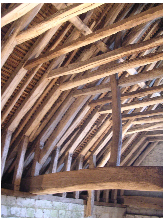
Fig. 72 Report des charges des pannes sur l'arbalétrier et le poteau, lui-même en appui sur l'entrait
