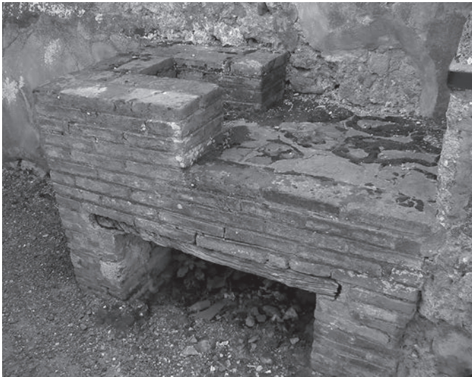
Fig. 5 – Table de cuisson dans le local VI 10, 1.19, vue du nord. À gauche de la table de cuisson, les montants permettant l'installation d'une chaudière, probablement en plomb (cliché : N. Monteix, Université de Rouen ; © Soprintendenza Speciale per i Beni Archeologici di Napoli e Pompei).
